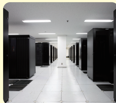
データセンター内部
